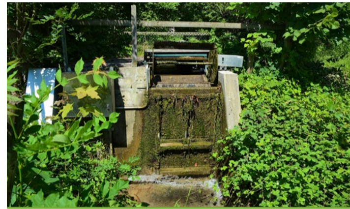
La prise d'eau de la conduite forcée sur l'Armary. L'installation est pilotée automatiquement en fonction du niveau d'eau. P.-A. CORDONIER
